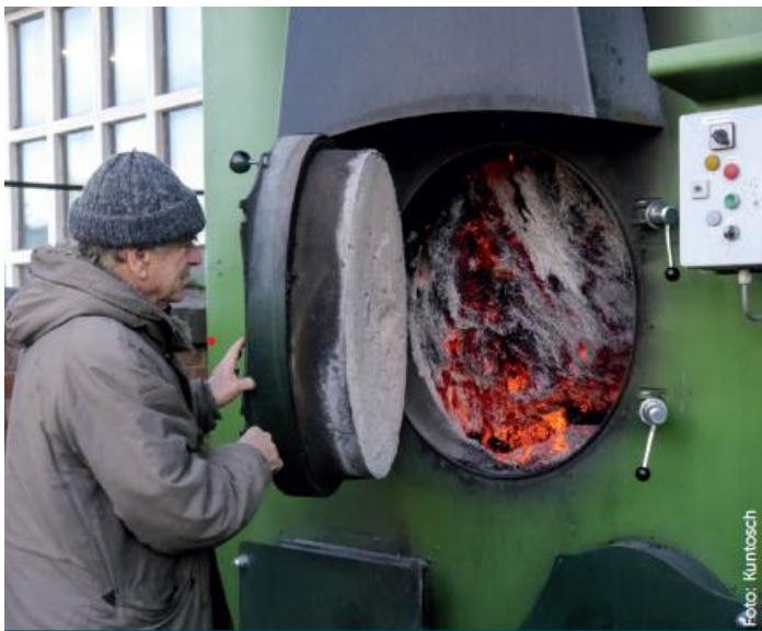
Abbildung 5-5 Wärmeproduktion durch Vergasung auf dem Hof der Görlitzer Agrar GmbH (Foto: Kuntosch)
