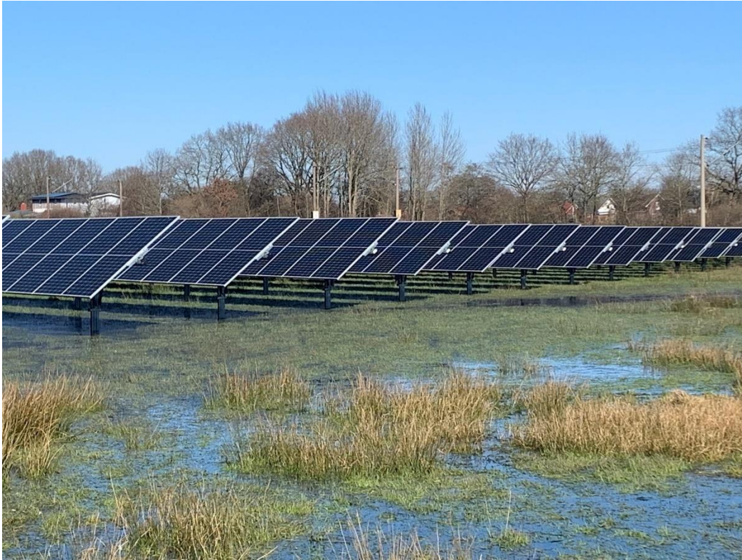
Abbildung 3-5 PV-Freiflächenanlage „Solarpark Lottorf“ der Wattmanufactur im teilweise wiedervernässen Niedermoor in Schleswig-Holstein (Foto: B. Spanjers)
