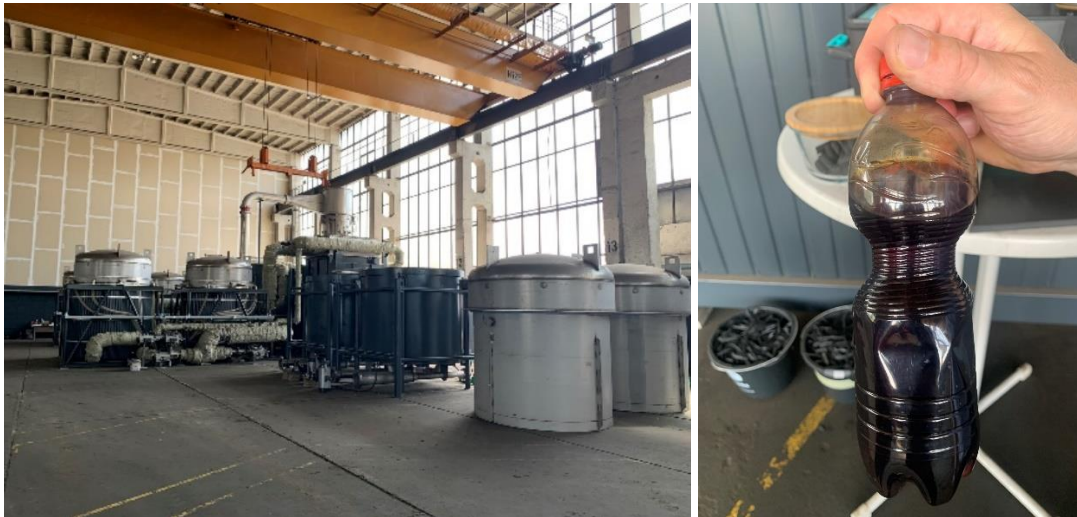
Abbildung 5-7 A. Pyrolyseanlage der Carbonauten in Eberswalde B. Neben den Pflanzenkohlen sind auch die gewonnenen Flüssigkeiten lukrative Produkte des Pyrolyse-Prozesses.
